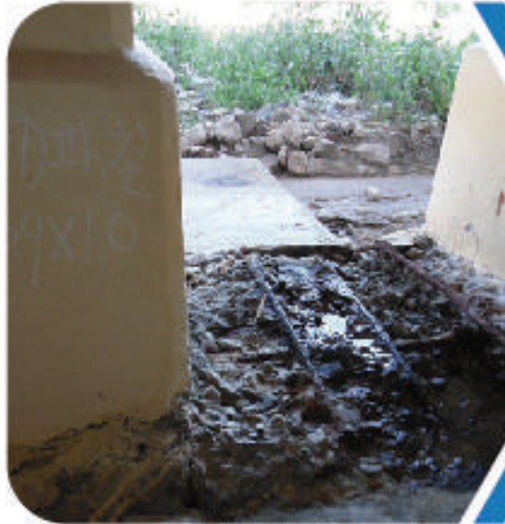
시공 전 : 바닥 균열
