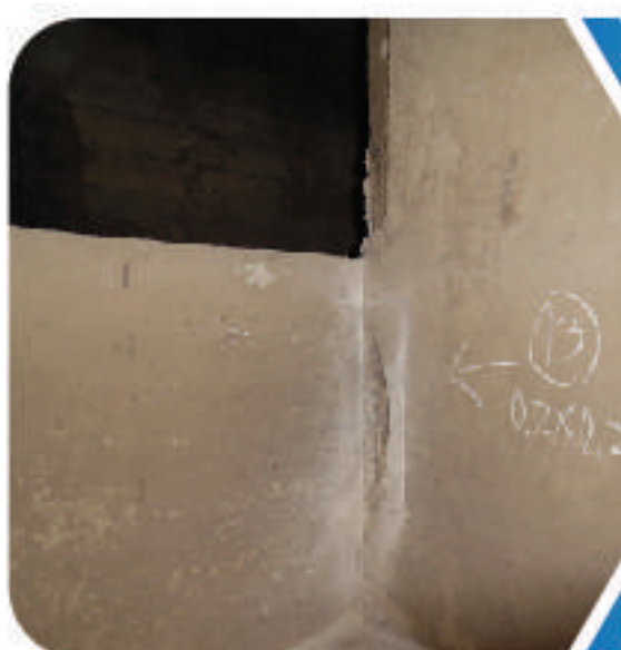
시공 전 : 기둥 균열
