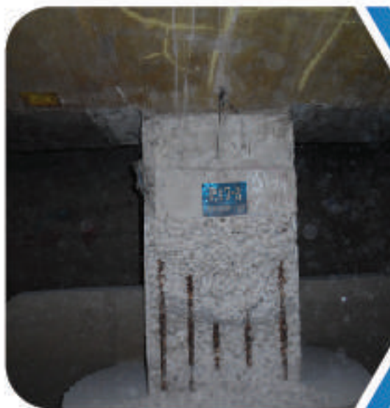
시공 전 : 기둥 균열
